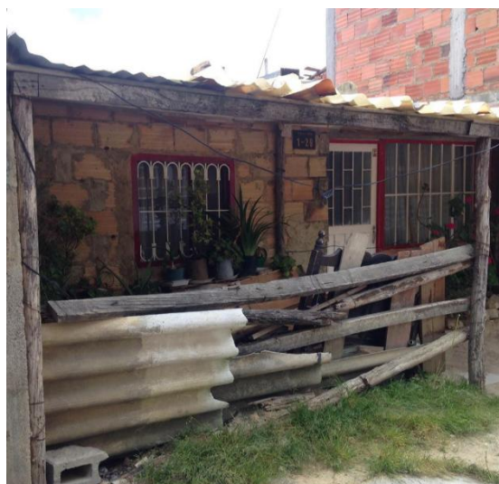
Figura 2: En distintas casas del pueblo de Sibaté se utilizan distintos materiales que contienen asbesto, mayo 2016.
